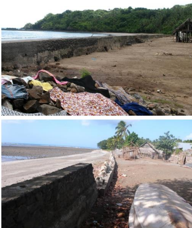
Figure 25 : Digue de protection du village de Domoni (haut) et digue partiellement détruite du village de Hoani (bas)
