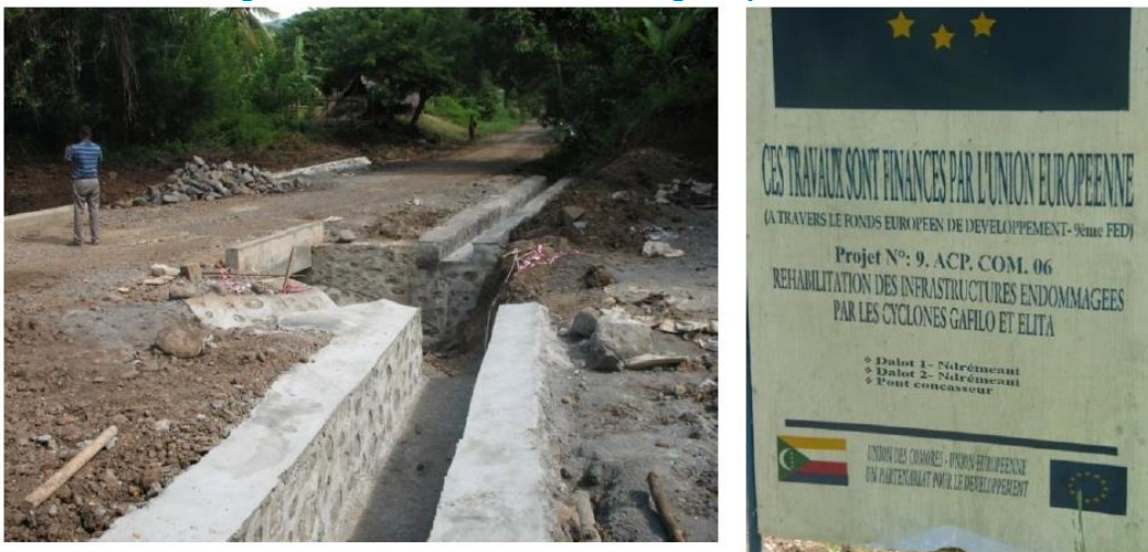
Photo 1 : Aménagements des routes endommagées par Gafilo et Elita à Ndrérémani
